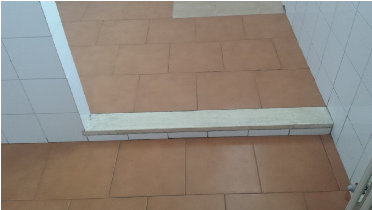
Dislivello zona bagni – docce
