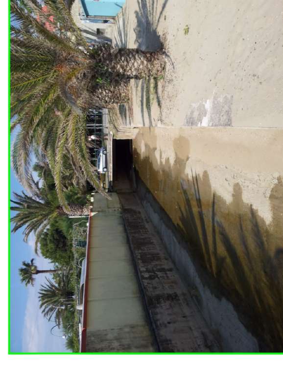
Foto n°5: La foto, presa da est, mostra il tratto finale del Fosso dell'Acquachiarra, a valle del lungomare. Esso risulta ancora rivestito per circa 30 metri verso la spiaggia.
